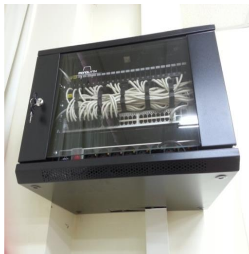
Rack 2 Planta Baja
